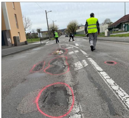
Les motards en colère ont dénoncé récemment la multiplication des nids-de-poule dans l'avenue du Champ-de-Mars. Depuis, les trous ont été colmatés avec des gravillons. Photo ER/Éloïse PINTO
